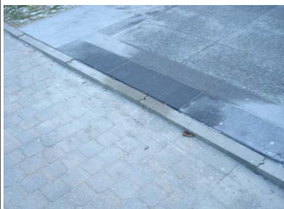
Photo 8 : Bordure un peu haute compliquant la circulation des personnes à mobilité réduite
