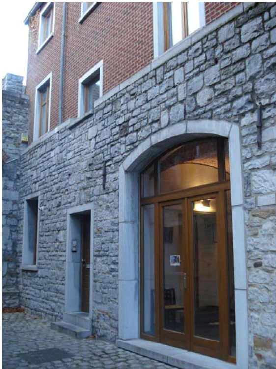
Photo 7 : Seuils et portes pas adaptés aux PMR
