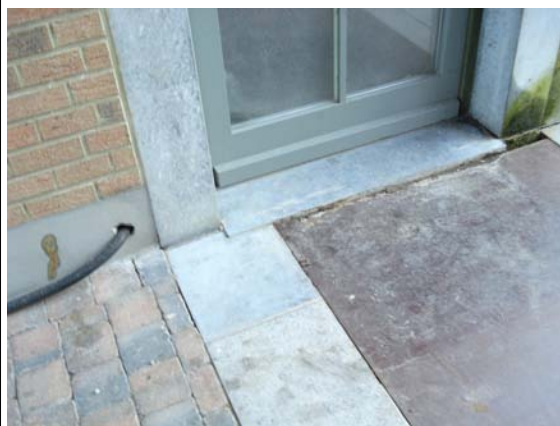
Photo 14 : Seuil d'entrée un peu haut
