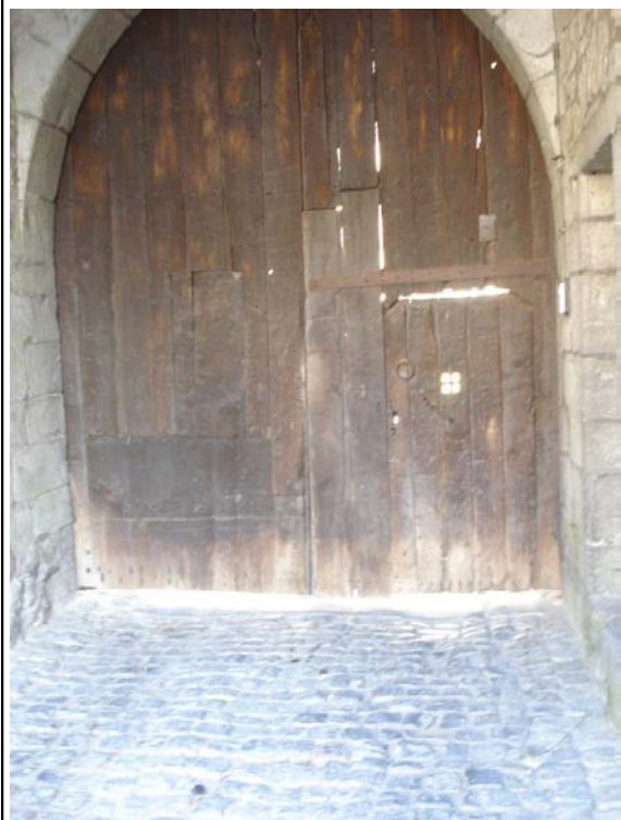
Photo 3 : Porte d'entrée difficilement accessible et sonnette trop haute pour les personnes en fauteuil roulant
