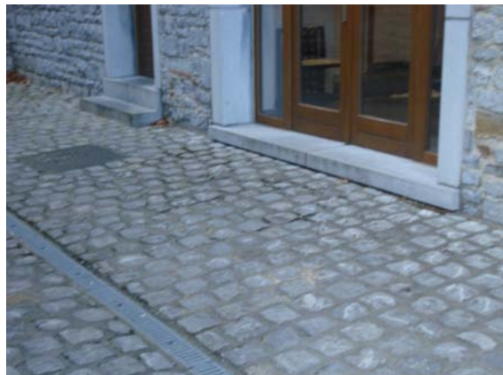
Photo 8 : Seuils et portes non adaptés et avaloirs dans le passage
