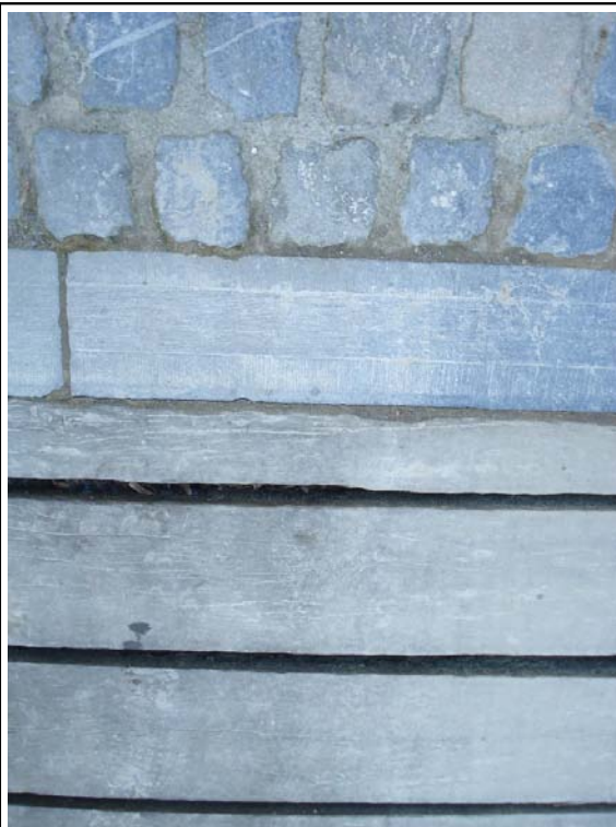
Photo 2 : Grands écarts entre les planches du pont levis
