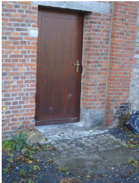
Photo 8 : Seuil trop haut
