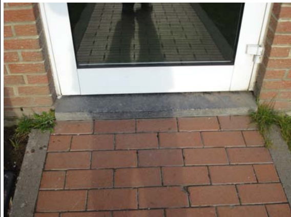
Photo 12 : Accès difficile à cause du seuil un peu haut
