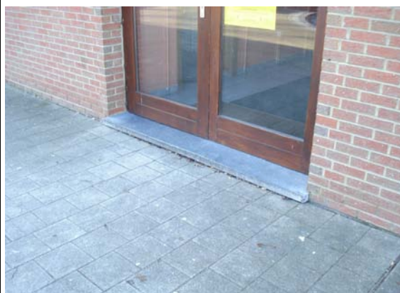
Photo 12 : Seuil un peu trop haut
