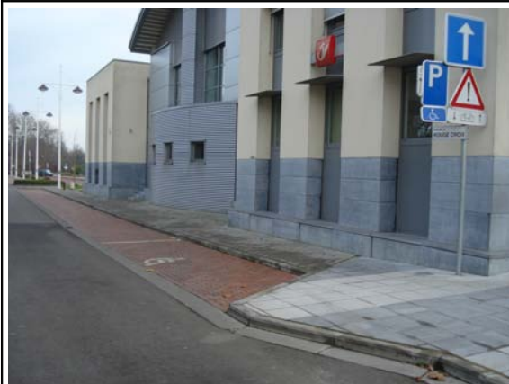
Photo 1 : Emplacement réservé pas aux normes et inaccessible sans danger
