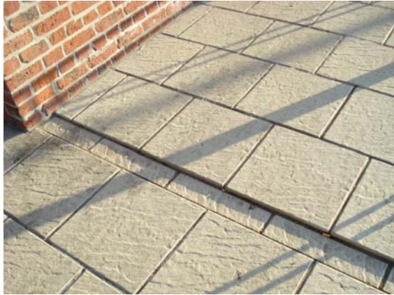
Photo 9 : Filet d'eau dans le passage
