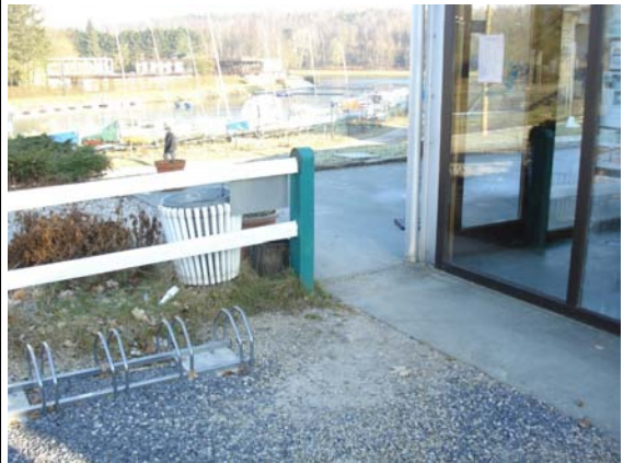
Photo 4 : Elements dangereux pour les malvoyants et libre passage inférieur à 150cm
