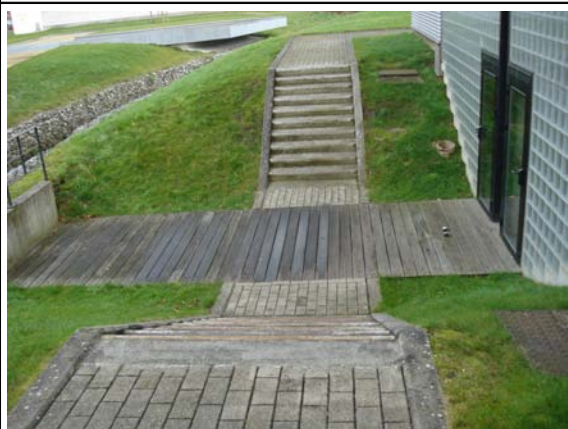
Photo 12 : Accès impossible aux deux portes du bas par les personnes à mobilité réduite. Dangereux escaliers non signalés. Manque d'éléments de protections pouvant provoquer une chute.
