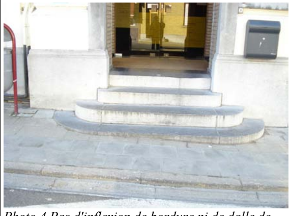
Photo 4 Pas d'inflexion de bordure ni de dalle de repérage. Seuil impraticable
