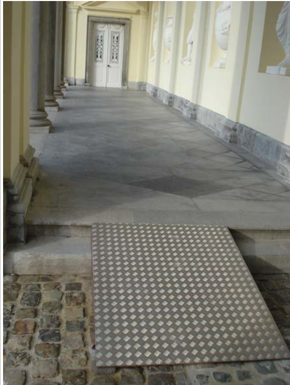
Photo 17 : Pente aménagée dangereuse pour les personnes aveugles et malvoyantes
