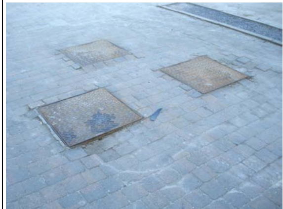
Photo 12 : Obstacles non sécurisés dans le cheminement
