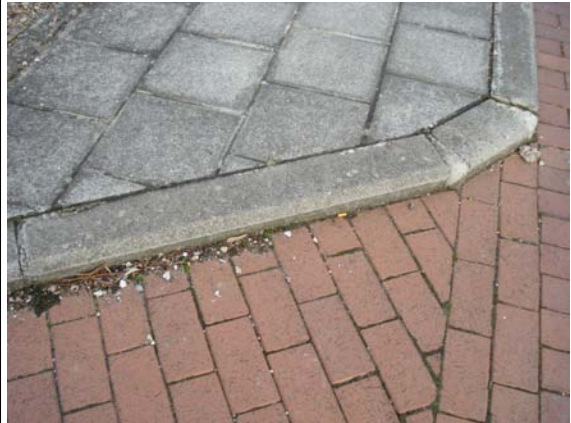
Photo 4 : Bordure un peu haute qui pourrait gêner le cheminement
