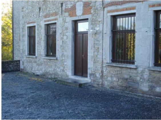
Photo 9 : Seuil trop haut
